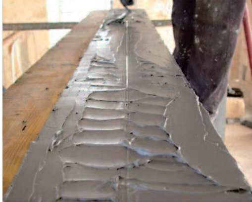
Figura 14 Rinforzo delle travi: stesura del primer epossiamminico sul supporto di calcestruzzo (a sinistra).
