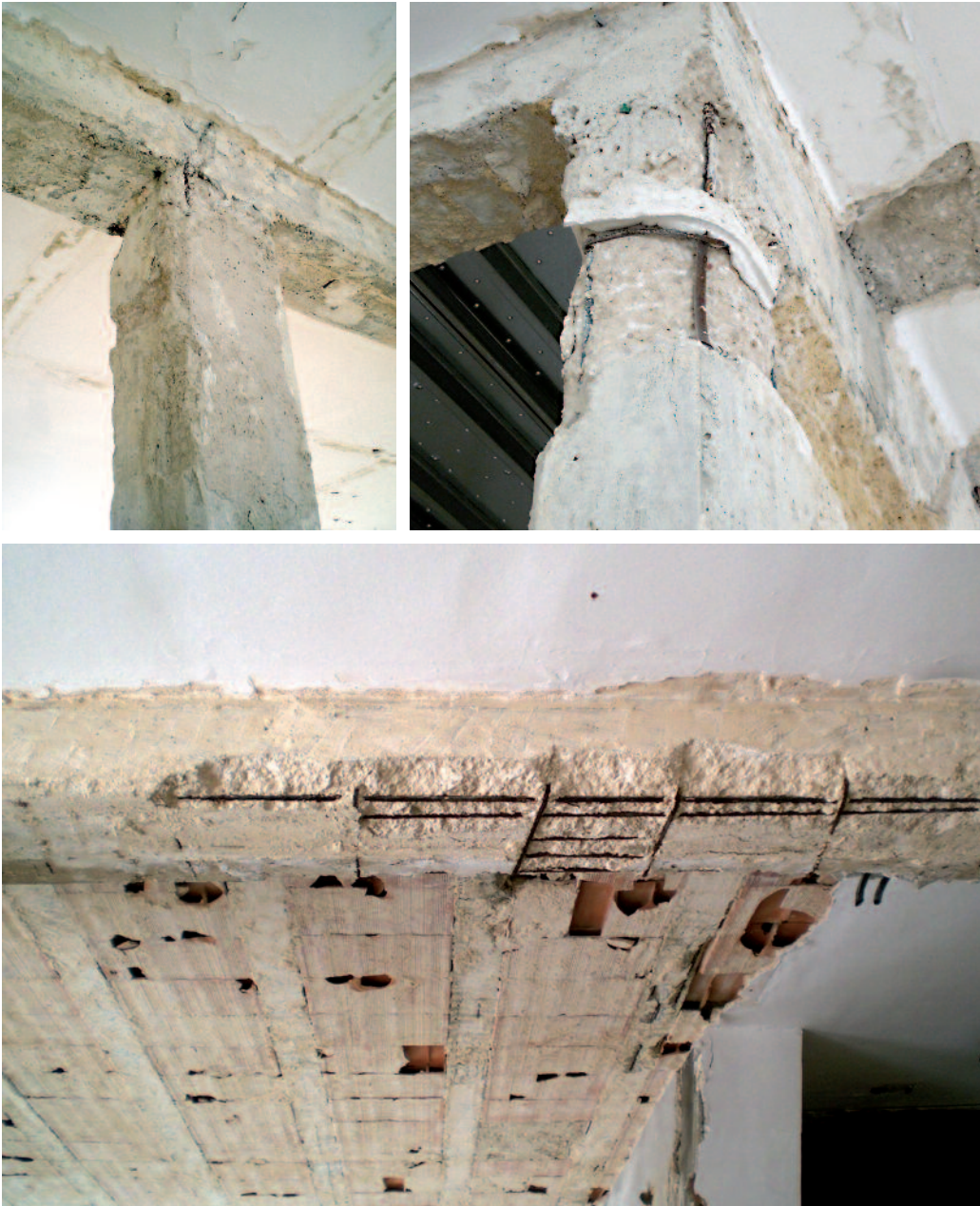
Figura 1 Valutazione dello stato di fatto, dettagli riguardanti la carbonatazione del calcestruzzo degli elementi strutturali, la perdita di copriferro e l'ossidazione dei ferri di armatura esposti.
