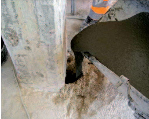
Figura 11 Rinforzo dei pilastri: colaggio del microcalcestruzzo fibrorinforzato mediante foro sul solaio (a sinistra).
